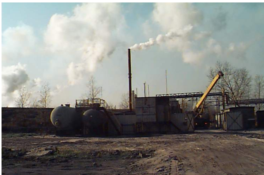
Стационарный промышленный комплекс по обезвреживанию диоксино-содержащих трансформаторных масел. Утилизировано 132 тонны «сотвола-10» (I класс опасности). ОАО «Северсталь» г. Череповец, Вологодская обл. 1999–2004 г. Работа удостоена отраслевой премии им. Бардина в 2000 году
