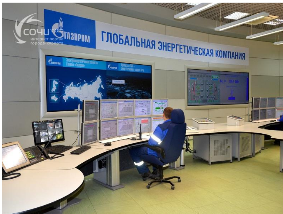
Рис. 3.8. Ситуационный центр ПАО «Газпром»
